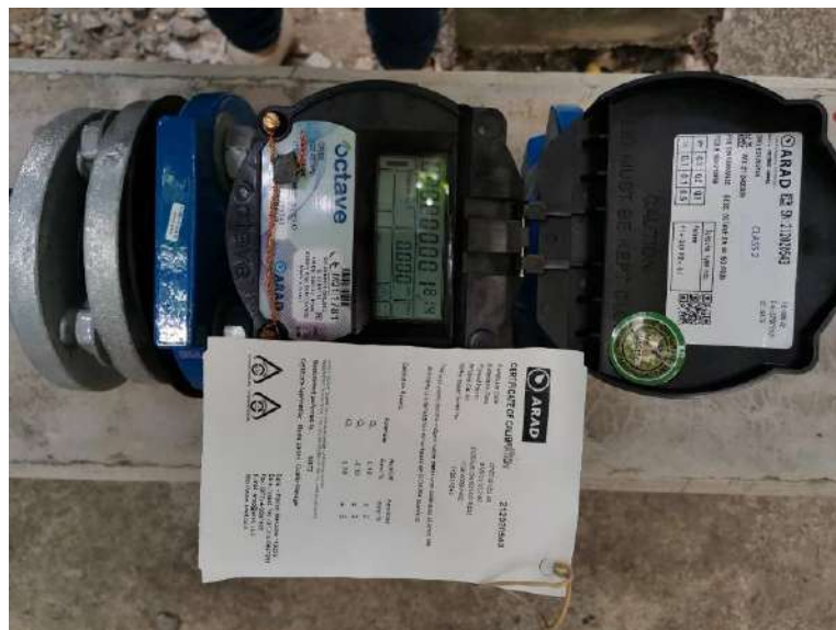
รูปที่ 5 หน้ามาตรบ่งบอกปริมาณการใช้น้ำประปาอิเล็กทรอนิกส์แบบอัลตราโซนิก ของแต่ละอาคารย่อย [3]
