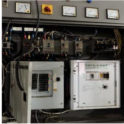
รูปที่ 11 แสดงการตรวจสอบระบบไฟฟ้าเพื่อความปลอดภัยในการปฏิบัติงาน
