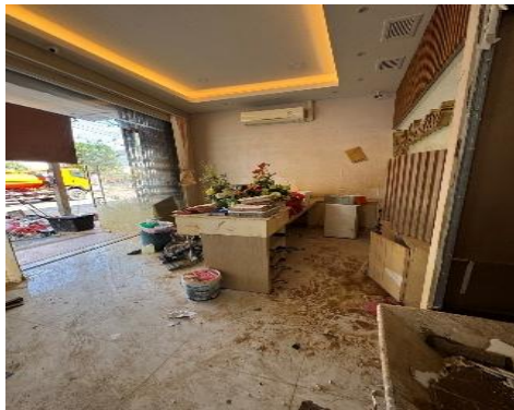
รูปที่ 7 แสดงการตรวจสอบสภาพความเสียหายภายในคลินิก
