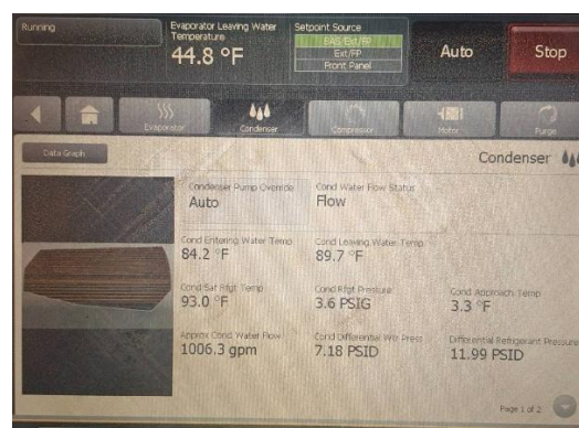
(ค) อัตราการไหลน้ำหลังติดตั้งอินเวอร์เตอร์
