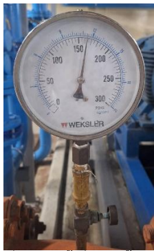
(ก) ค่าแรงดันน้ำก่อนติดตั้งอินเวอร์เตอร์
