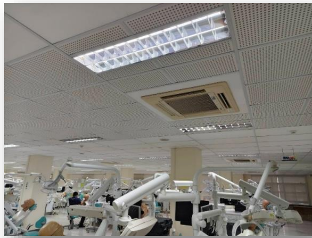
รูปที่ 1 เครื่องปรับอากาศก่อนปรับปรุง
